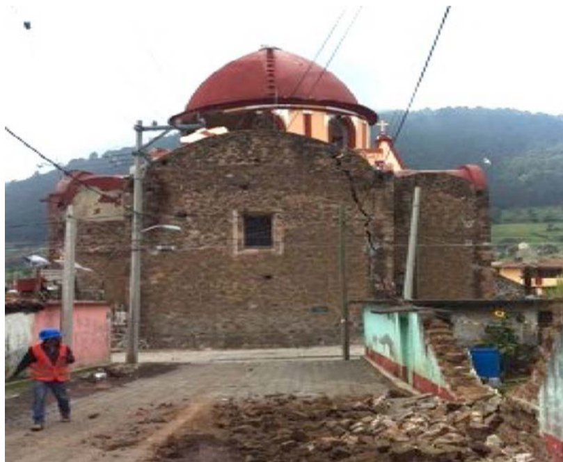
Figura 2. Parroquia de San Francisco de Asís en la comunidad de Tepexoxuca, colindante con el municipio de Joquicingo; presentó daños severos en la cúpula, campanario, bóveda y muros. Fotografía: Elda Gómez Rogel.
